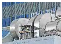
Bombas Compresoras de Aire HVAC
